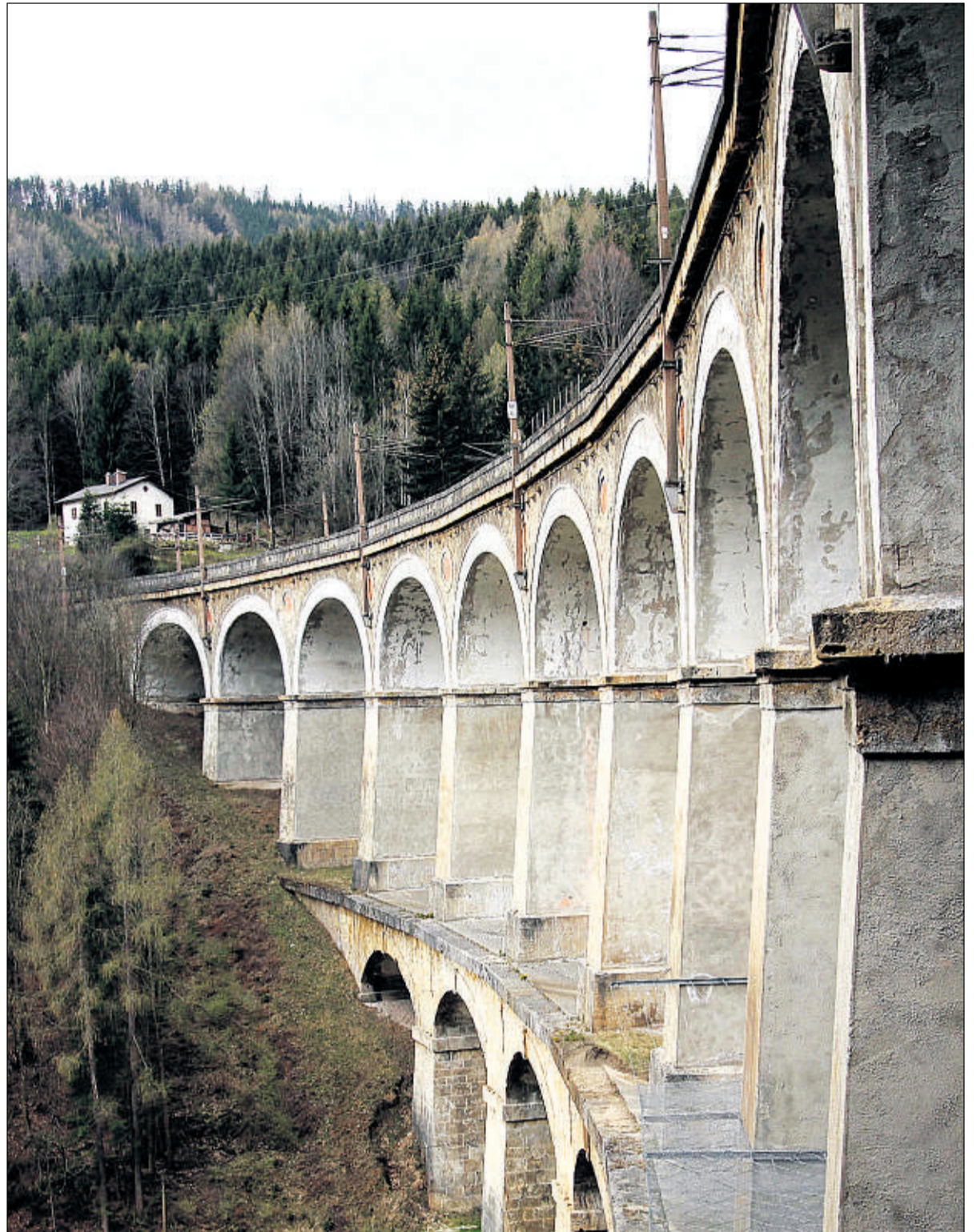
Insbesondere wegen des Doppelstock-Viadukts „Kalte Rinne“ ist der Semmering Welterbe. Foto: AP/Zak
