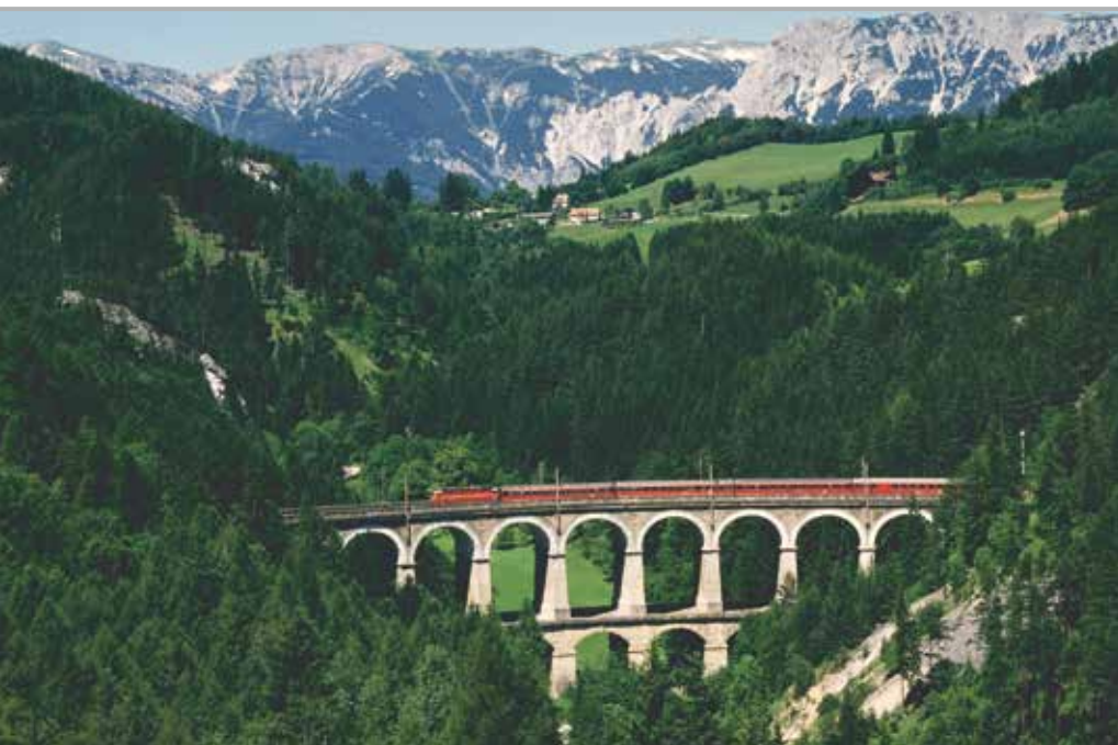
Das Viadukt über die Kalte Rinne ist das mächtigste und zugleich bekannteste Bauwerk der Semmeringbahn (© Archiv Alliance For Nature).
